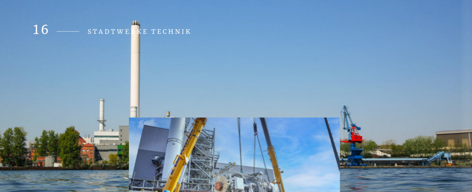
← Koloss am Haken: Die Platzierung der 41 t schweren Gasturbine war echte Schwerstarbeit.
