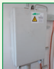
Abb. 10: Hausanschlusskasten mit Sicherungen
