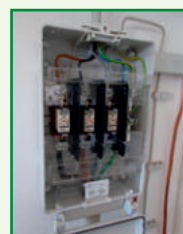
Abb. 11: Hausanschlusskasten mit Sicherungen
